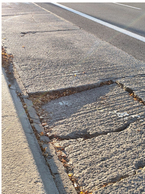
Foto 6 Širší detail propadlého betonového bloku, prasklin a vydrolených okrajů.
