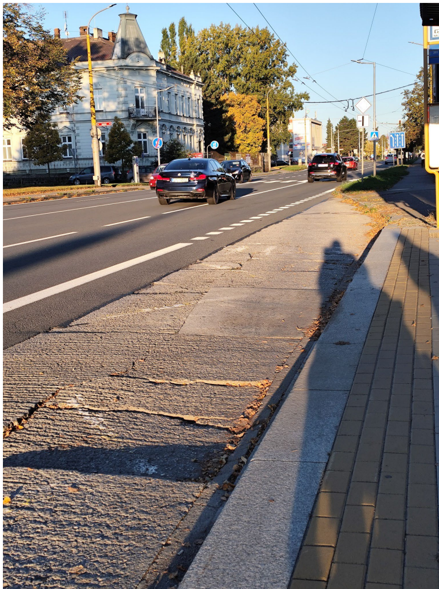
Foto 7 Pohled na poškození zálivu podél nástupní hrany zastávky z opačné strany.
