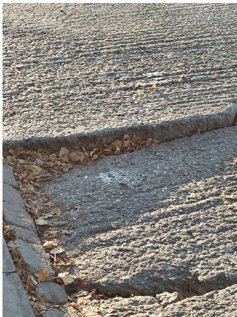
Foto 5 Detail propadlého betonového bloku a výškové nerovnosti vůči navazujícímu povrchu.
