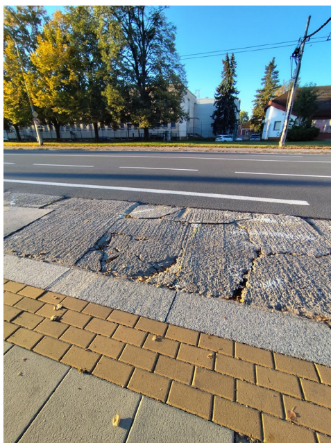
Foto 4 Pohled na popraskané a vydrolené části povrchu u nástupní hrany zastávky.
